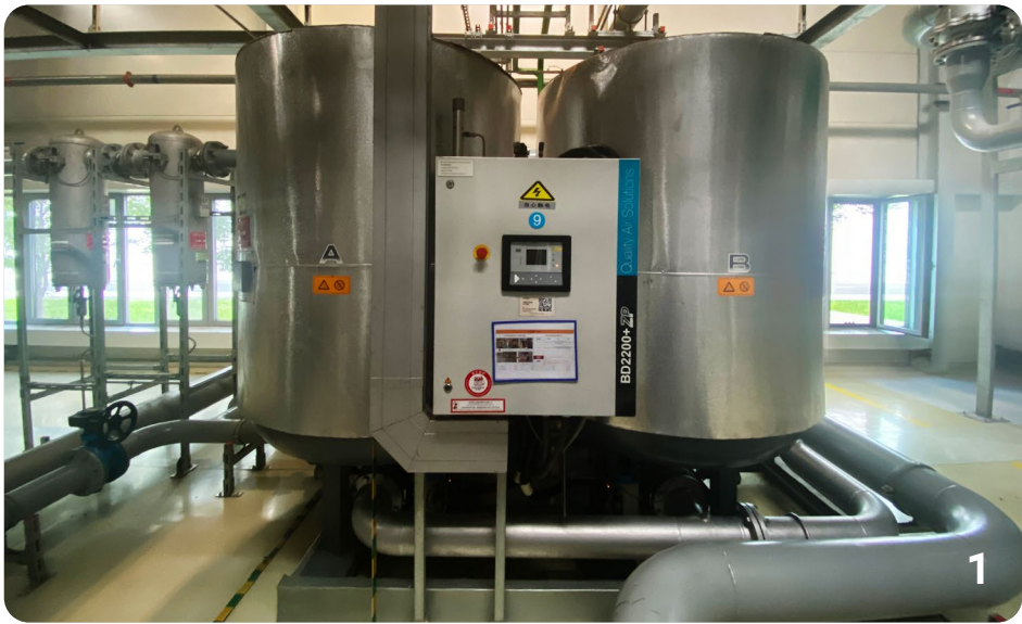
1. 空压系统的零气耗干燥机
